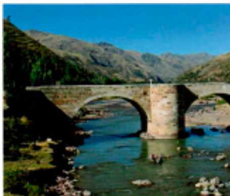
48. Puente de cal y canto que comunica las localidades de Yauri y Corporaque. Provincia de Espinar.
